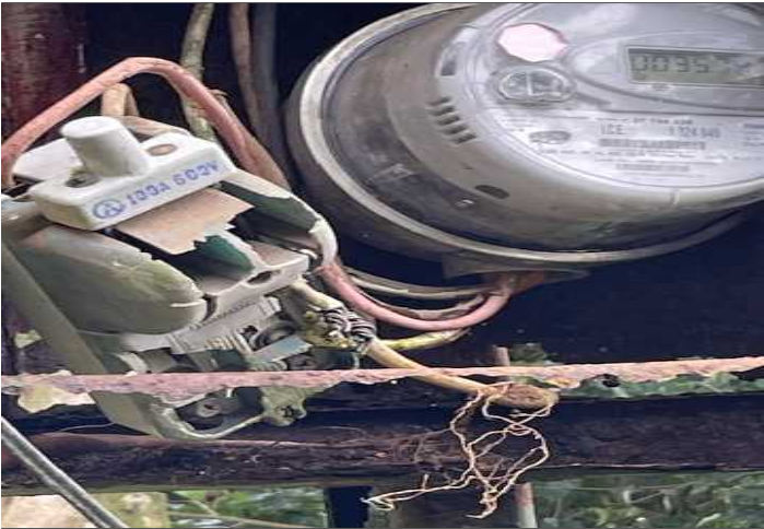
Descripción: ASPECTO DE LAS CONSTRUCCIONES. ZONA DEL MEDIDOR EN EL EXTERIOR
