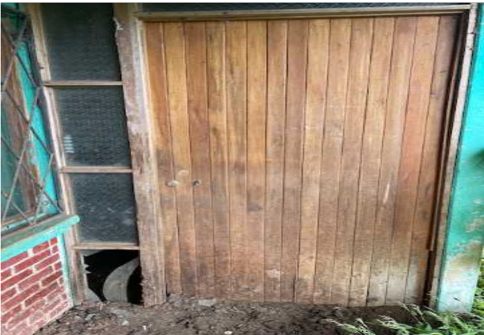
Descripción: ASPECTO DE LAS CONSTRUCCIONES. ENTRADA A AMPLIACIÓN. VIDRIO ROTO
