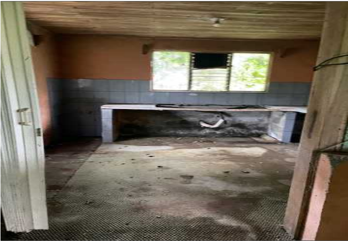
Descripción: ESTADO DE LAS CONSTRUCCIONES
