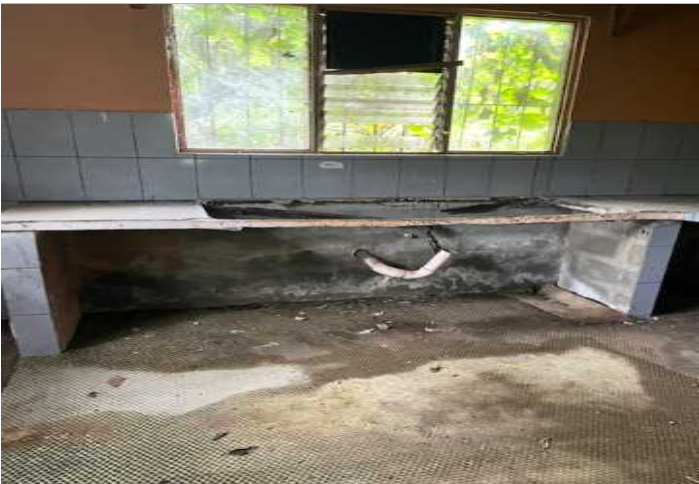
Descripción: ESTADO DE LAS CONSTRUCCIONES. TUBERÍA Y FREGADERO
