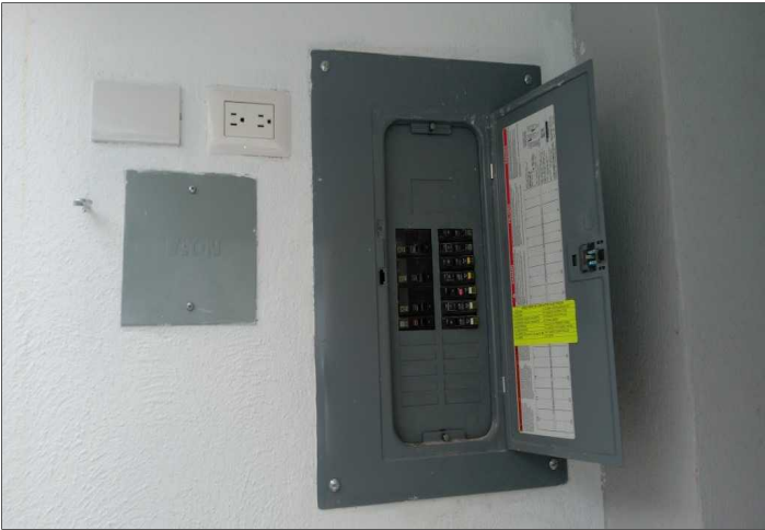
Descripción: Caja de Interruptores
