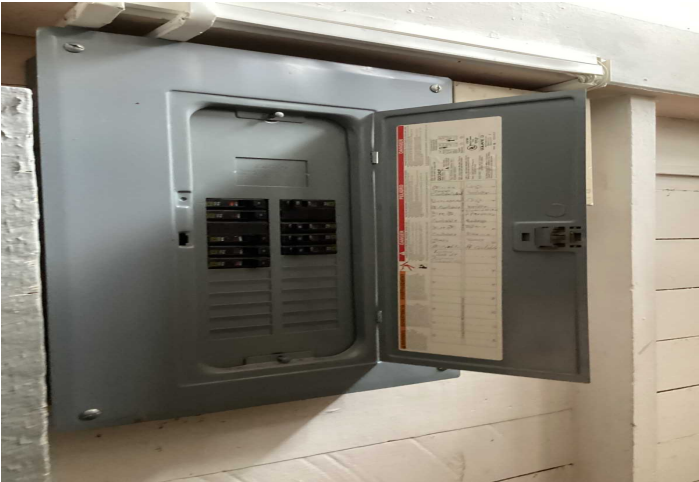
Descripción: TABLERO ELÉCTRICO
