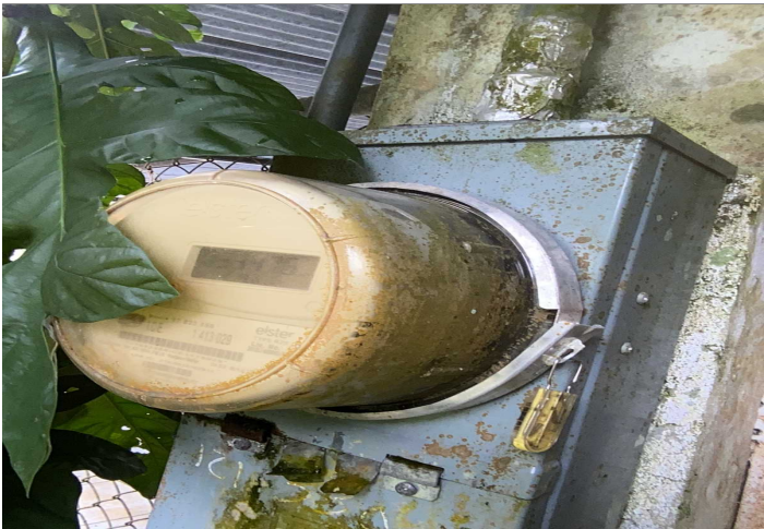
Descripción: MEDIDOR ELÉCTRICO
