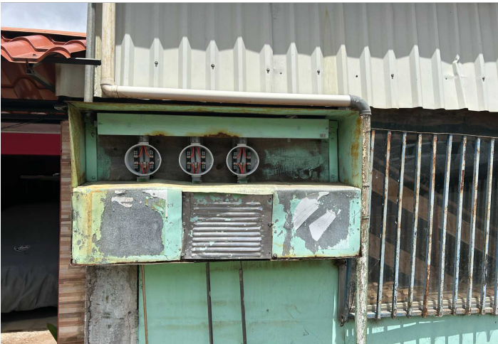
Descripción: Banco medidores eléctricos
