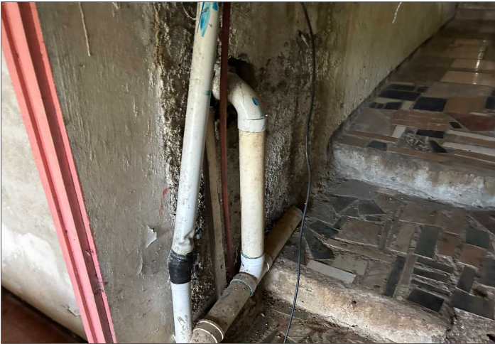
Descripción: Tuberías mecánicas
