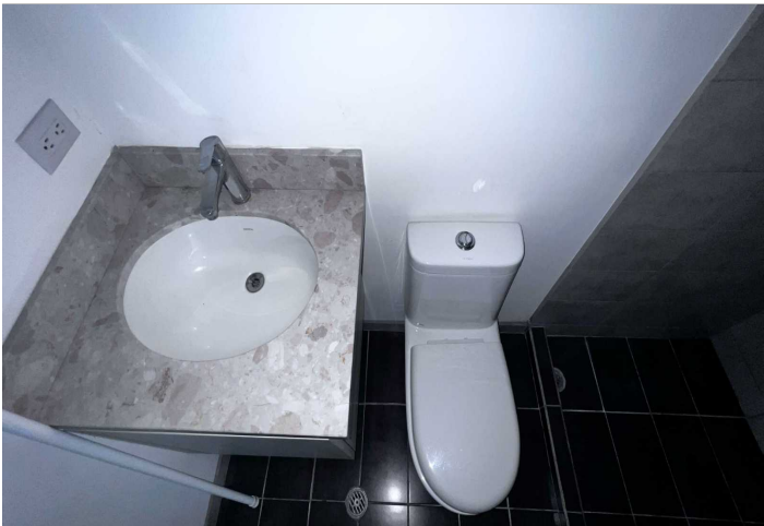
Descripción: PIEZAS SANITARIAS BAÑO COMPLETO SECUNDARIO
